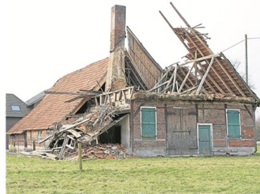
Das Dach des alten Bauernhauses ist schon halb abgerutscht, doch der Heimatverein Burlo sieht großes Potenzial, um das Haus wieder komplett andernorts aufzubauen.
